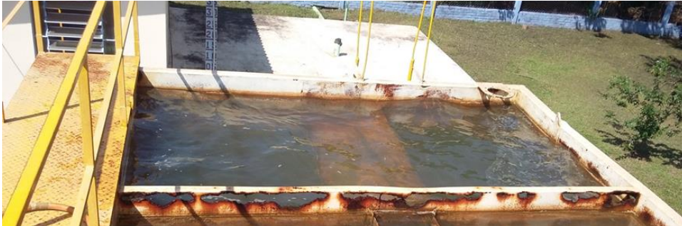
Figura 5 - Unidade de Filtração
