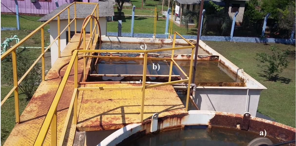
Figura 1 - Vista da parte superior da ETA semi-compacta com Tratamento Convencional para a potabilização da água
