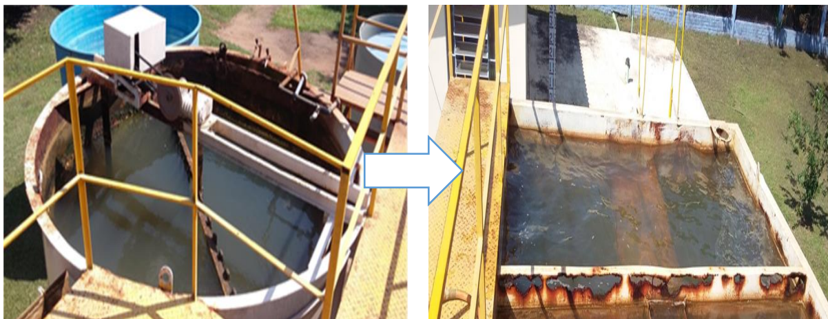
Figure 10 - Coagulação/sedimentação seguida de filtração
