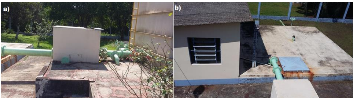
Figura 6 – Unidade de desinfecção e reservatório semi-enterrado
