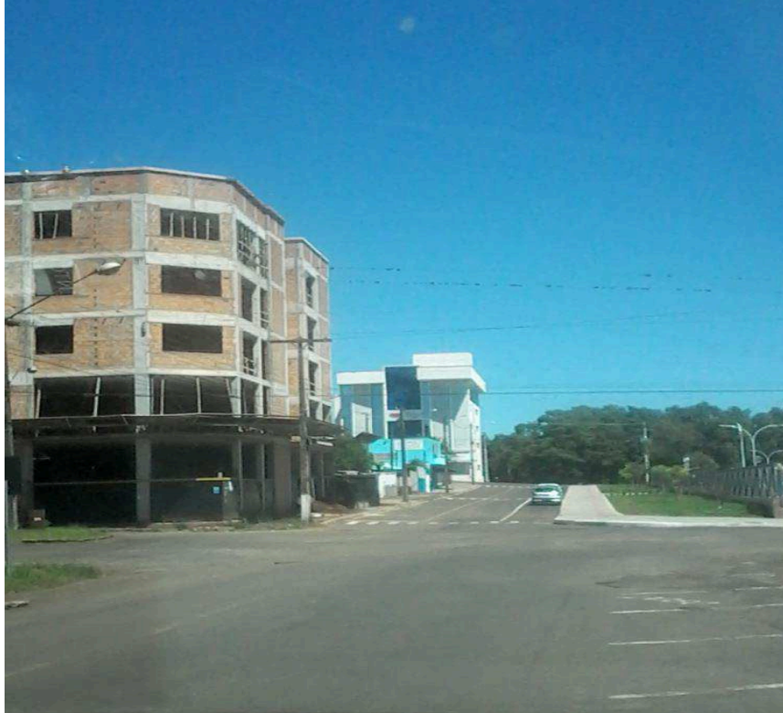
Figura 12. Prédio em construção no Centro da cidade de Xaxim. Foto: Mirian Pegoraro (12/11/2017).
