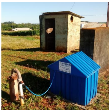
Figura 4- Poço Vila Santo Antônio
