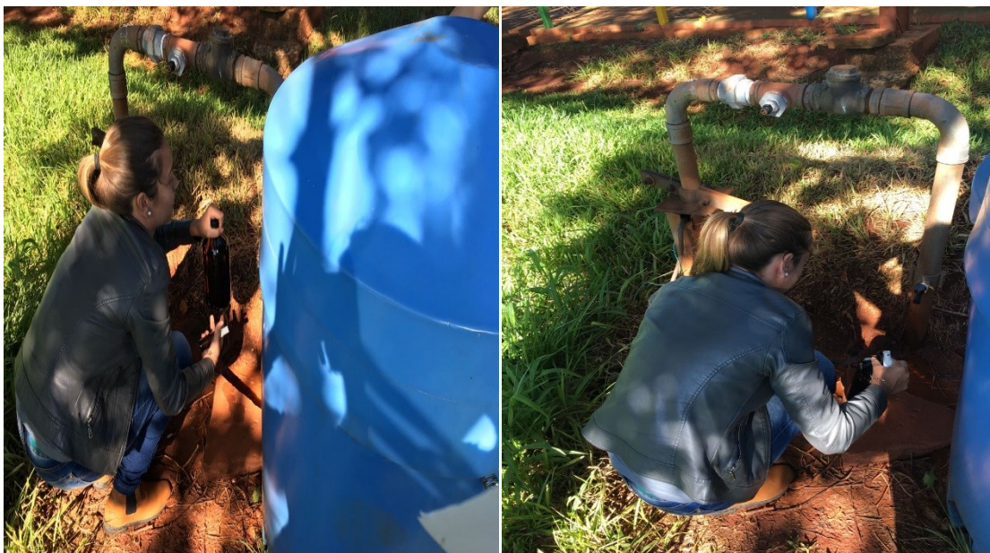
Figura 20 - Poço de captação de água subterrânea localizado na comunidade da Trêmonia
