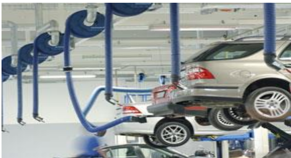
Figura 22 - Sistema de exaustão veicular
