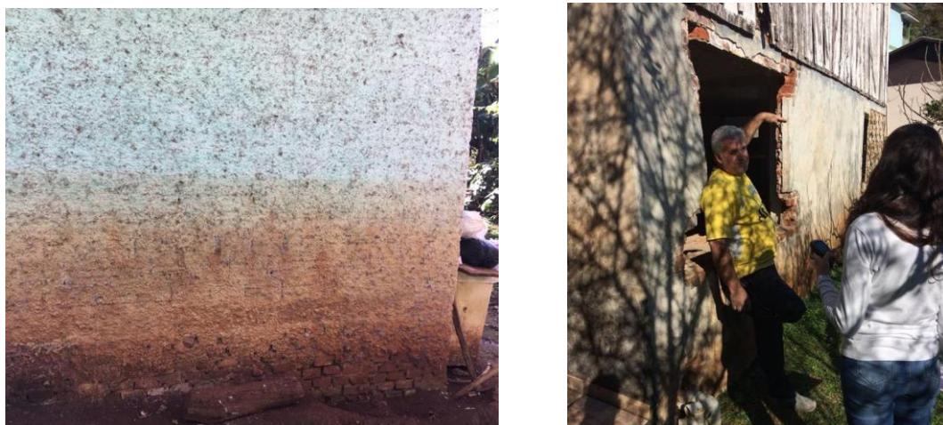
Figura 3 – Marcas de inundações na área urbana de São Carlos-SC
