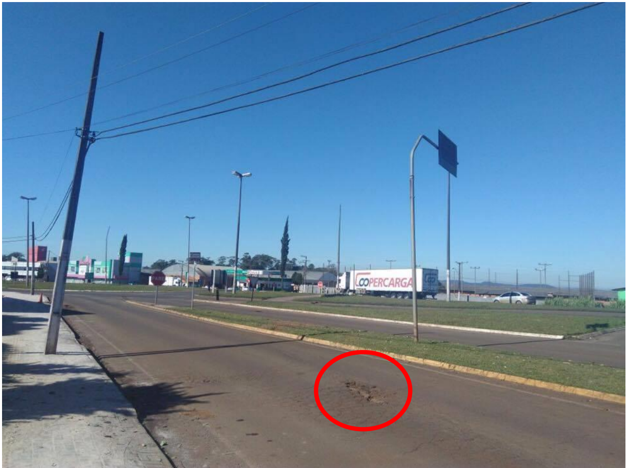
Imagem 7: Trevo de Nova Erechim, problema estrutural no asfalto
