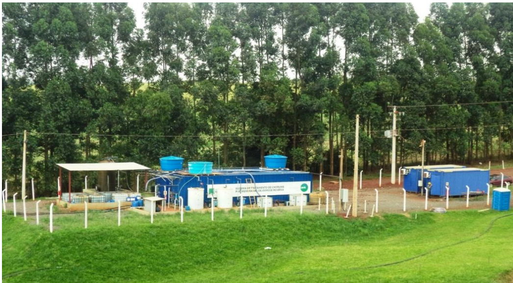
Figura 12: Equipamento que realiza o processo de osmose do lixiviado.
