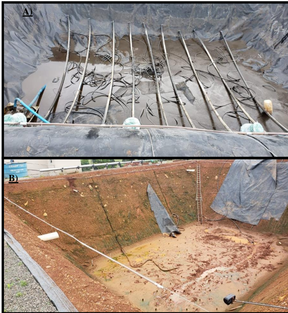
Figura 18 – Problemas estruturais em reator nitrificante devido ao sistema de aeração
