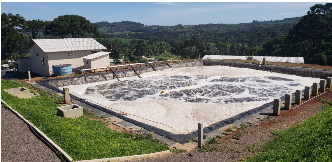
Figura 13 – Reator aeróbio/nitrificante, segundo e último reator do Módulo N onde ocorre a oxidação do nitrogênio amoniacal em nitrito e nitrato
