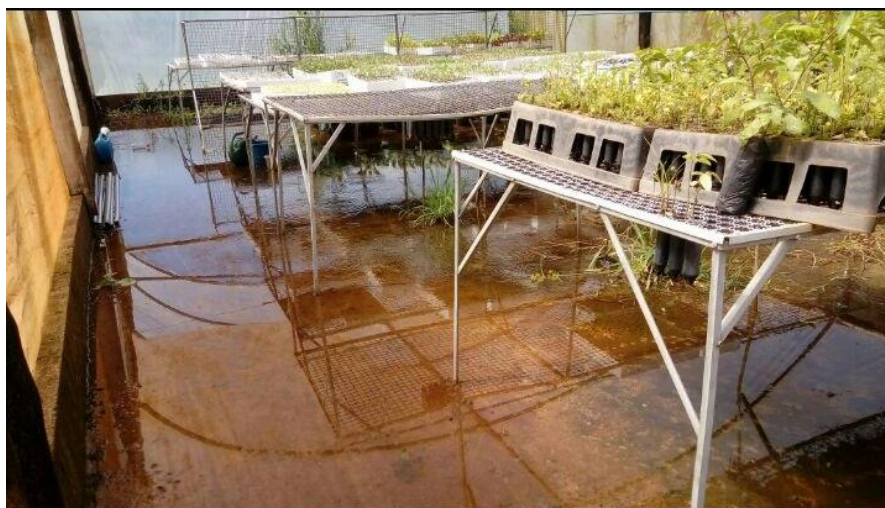
Fotografia 2 - Alagamento na casa de vegetação pela entrada da água da chuva através da cobertura
