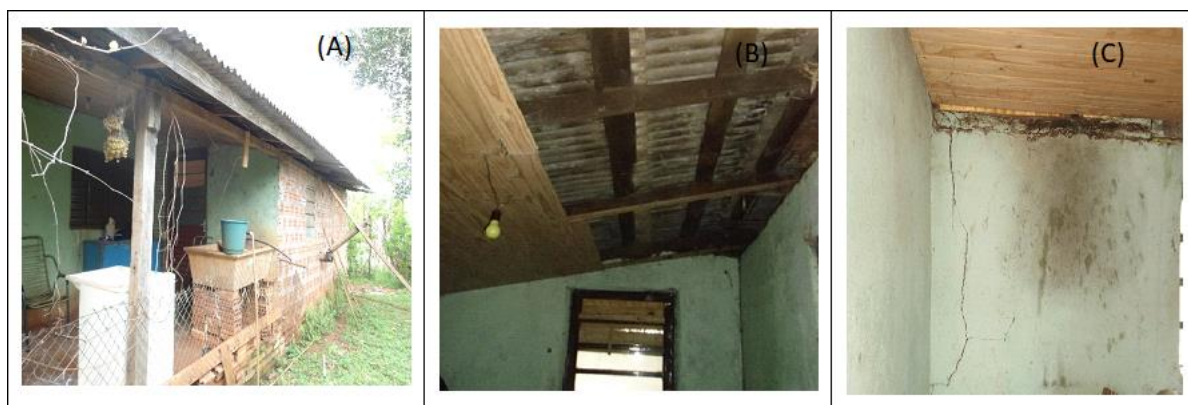
Figura 16 - Situação da residência anterior ao PNHR: (A) Frente da residência; (B) Teto da sala; (C) Paredes da cozinha com rachadura
