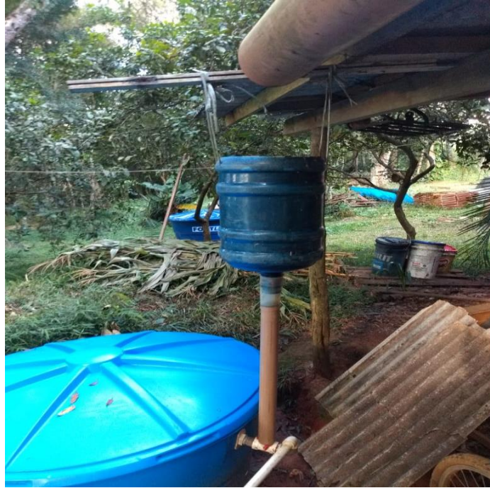
Fotografia 4 – Sistema de captação, filtragem e armazenamento da água da chuva
