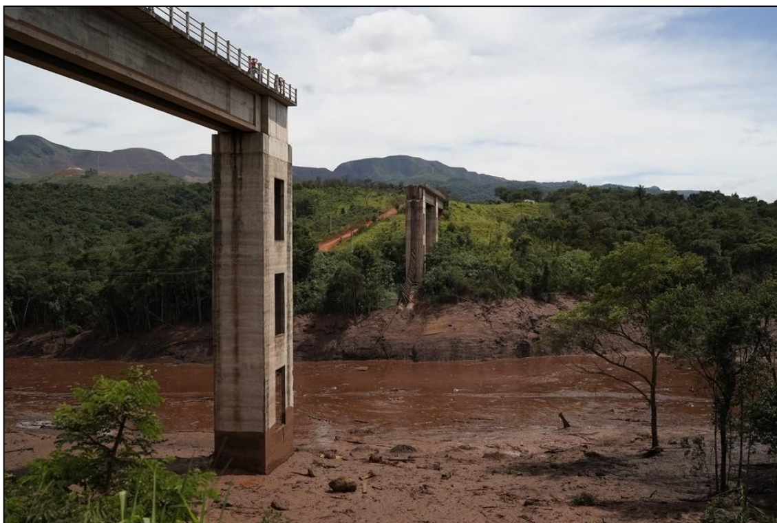
Imagem 6: Pontilhão destruído pelo rompimento da barragem em Brumadinho - 2019
