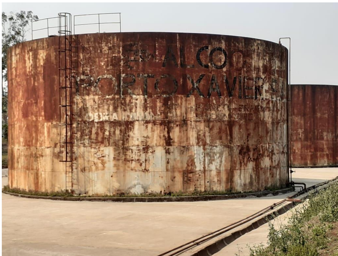
Figura 6 - Tanques de Armazenamento de Etanol
