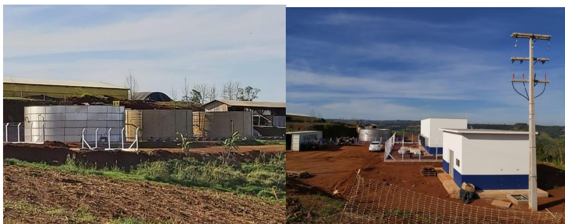
Figura 34 - Mini Central de biogás e biodigestores de aço e madeira
