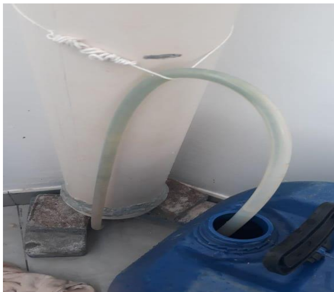
Figura 19 - Algas no duto de saída do filtro
