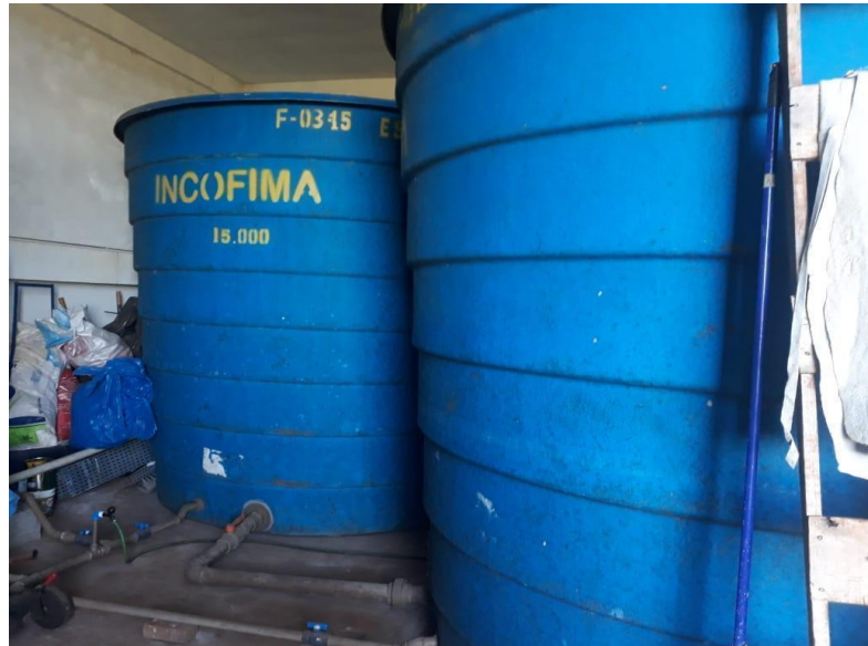
Figura 4 - Reservatórios de água pluvial
