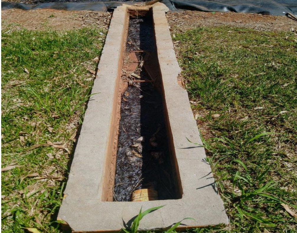
Figura 24 – Calha Parshall sem manutenção
