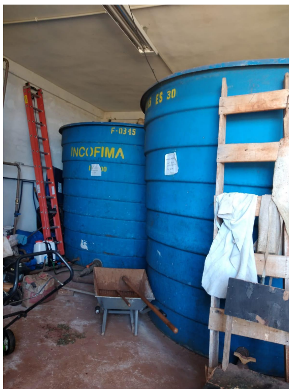
Figura 7: Reservatório de 30.000 L de água de reúso na parte inferior do Bloco dos Professores.
