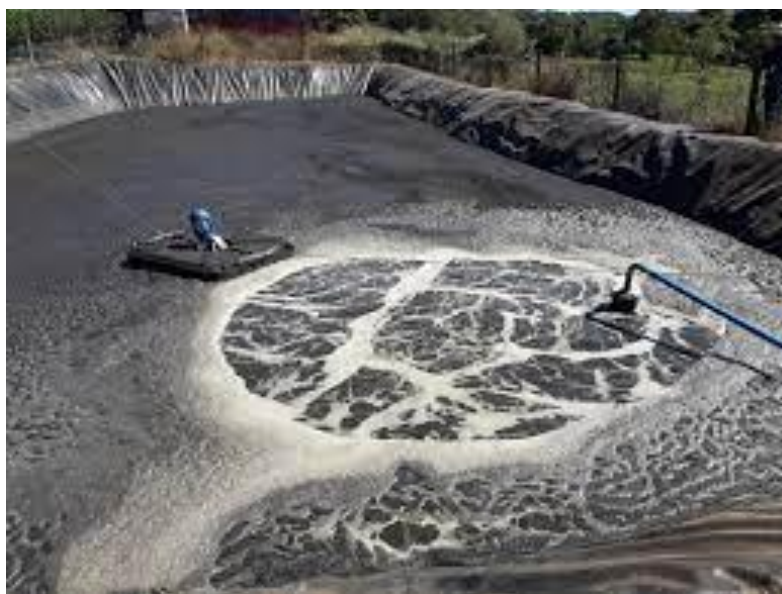
Figura 6. Esterqueira para armazenamento de resíduos líquidos. Fonte: Barros et al., 2019.
