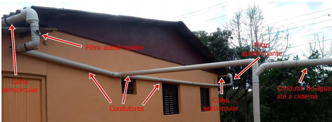
Figura 26 - Calhas e condutores
