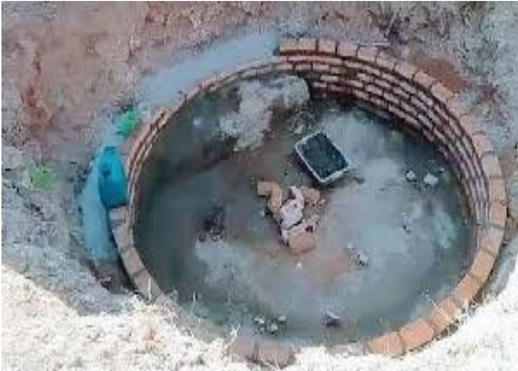
Figura 12 - Cisterna de tijolos
