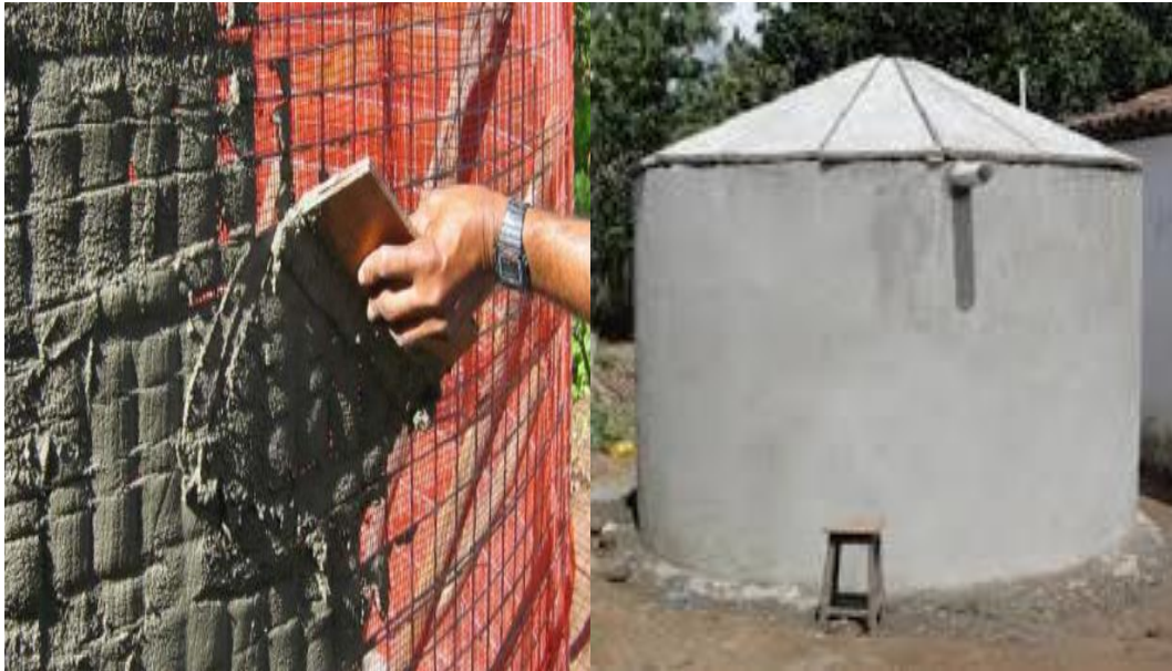
Figura 10 - Cisterna de tela de alambrado
