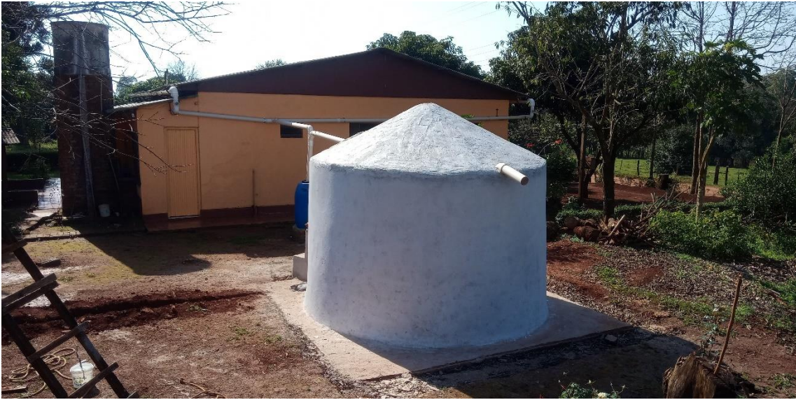
Figura 67 - Sistema de captação de água da chuva vista dos fundos
