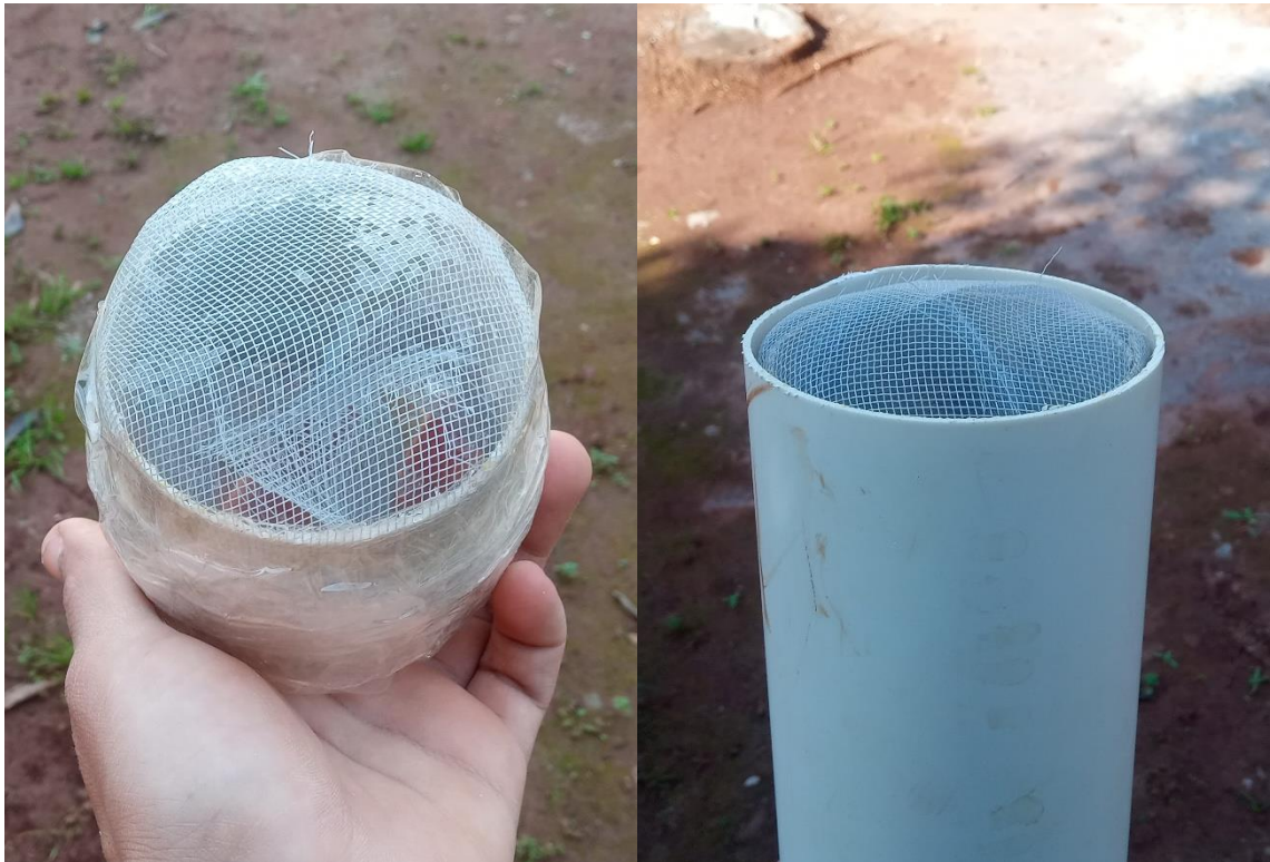
Figura 60 - Colocação de uma telinha de mosquiteiro no cano que serve para extravasar o excesso de água da chuva
