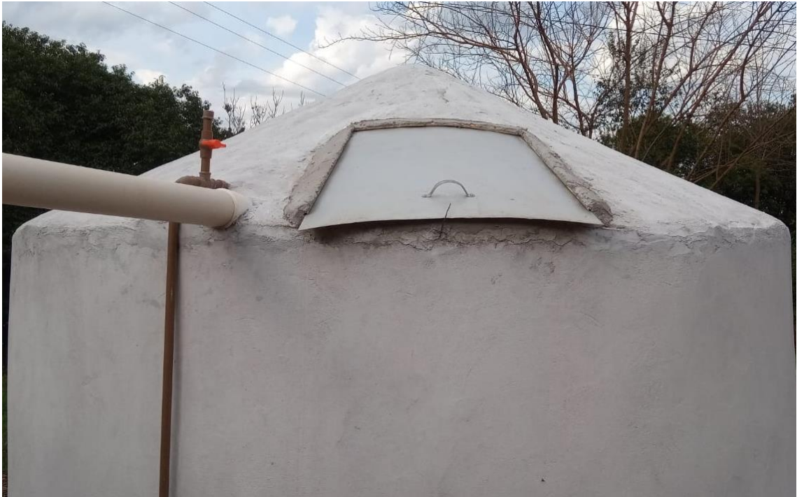
Figura 59 - Tampa instalada na cisterna
