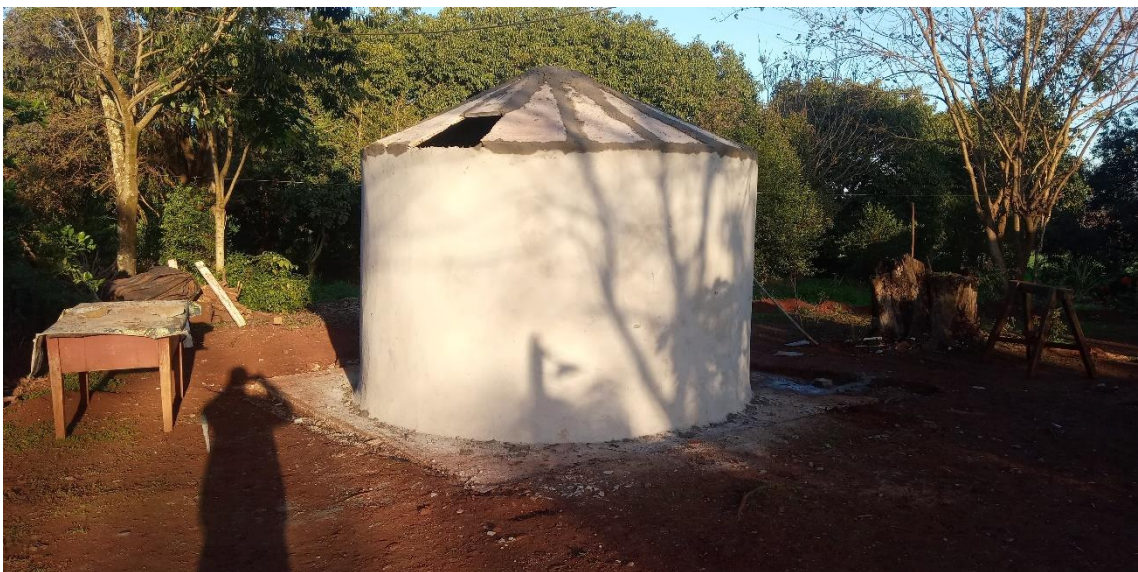
Figura 55 - Teto da cisterna com os espaços entre as placas preenchidos
