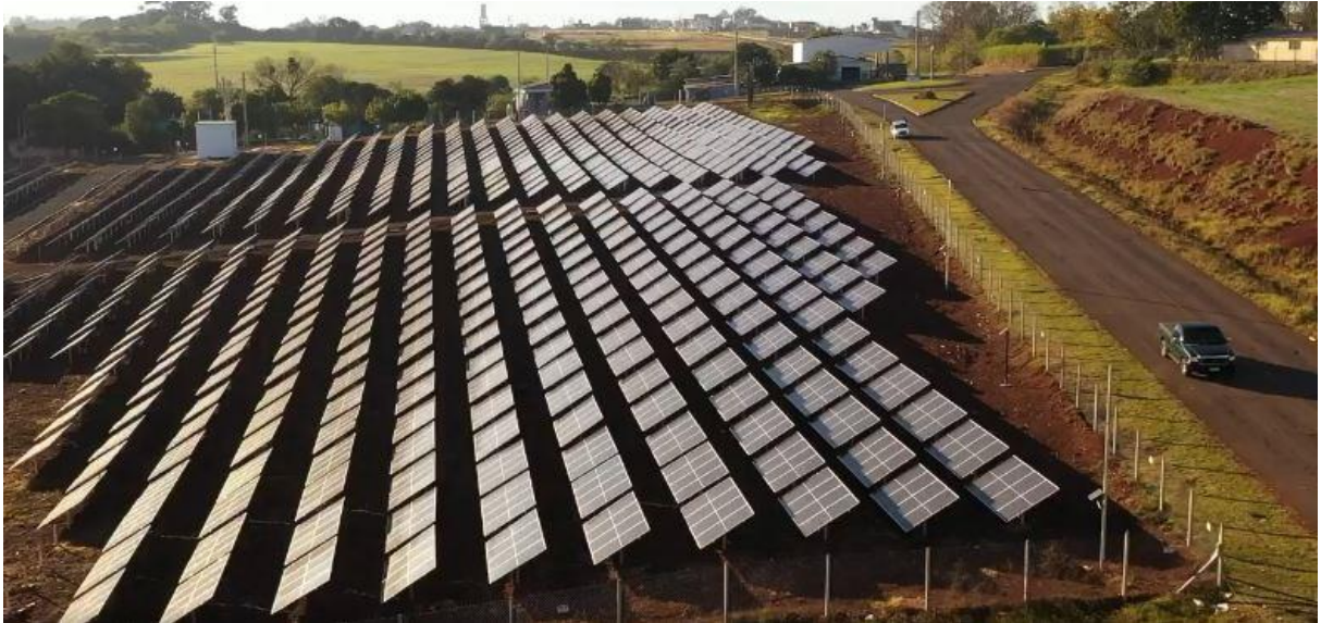
Figura 3: Usina fotovoltaica (Adaptado de Unimed Missões/RS)
