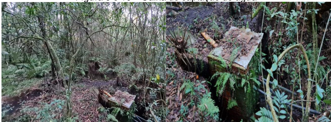
Figura 9 e 10 – Caixa de captação de água
