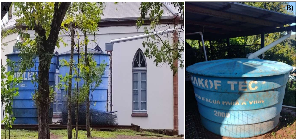
Figura 7 – Sistema de captação e armazenamento de água pluvial
