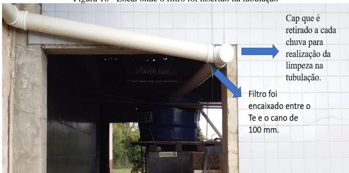
Figura 16 - Local onde o filtro foi inserido na tubulação
