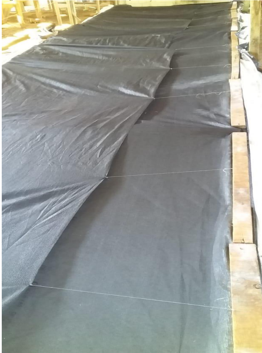
Figura 20 - Reservatório com a capacidade de 26m 3 com a tela
