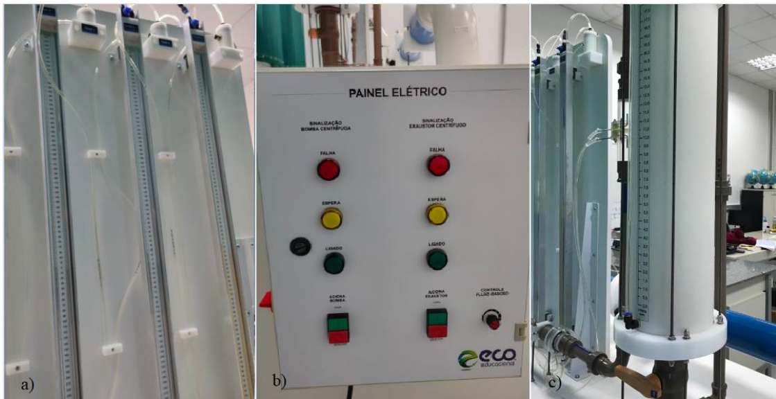
Figura 24 – a) Manômetro 1, 2 e 3; b) Painel elétrico; c) Recipiente graduado para vazão real de calibração.
