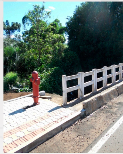
Foto 6: Calçada em desacordo com a NBR 9050 (Fonte: Acervo pessoal, 2015).
