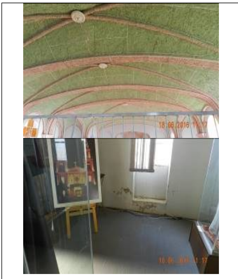
Figura 10 - Teto da Igreja com rachaduras / Paredes do ambiente interno (Fonte: Marceane Catia Santolin Biscaro, 2016)
