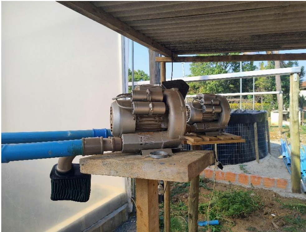
Figura 2: Compressor radial para oxigenação;
