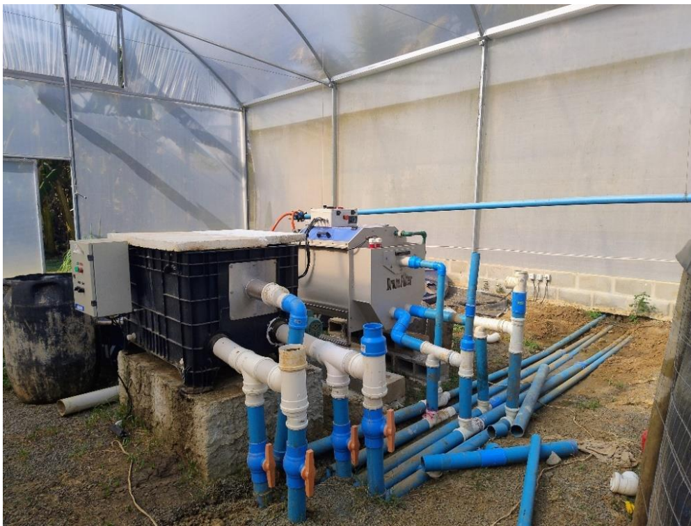
Figura 5: Sistema de filtragem mecânica
