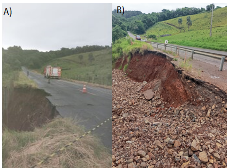
A) Cicatriz de colapso do solo na rodovia SC 283 ocorrido no dia 08/02/2024. Foto: Imprensa 3 ª RBM/Oeste. B) Cicatriz do movimento de massa ocorrido no dia 08/02/2024, ainda sem reparo efetivo. Foto: Deonísio Farias Rodrigues, 12/10/2024.
