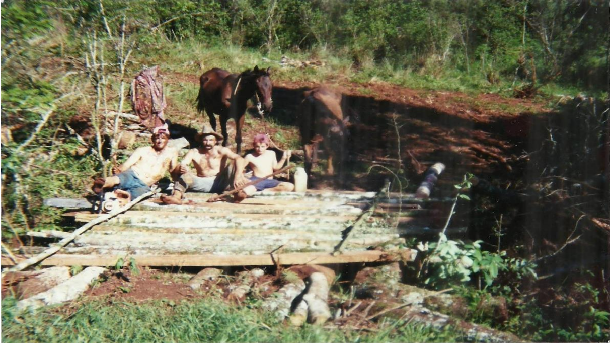
Figura 05 - Construção de ponte sobre sanga na Comunidade Linha Santa Cruz, ano de 2000.
