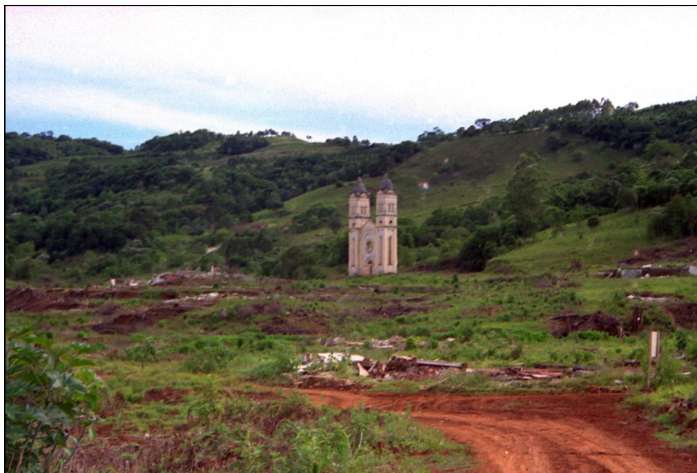
Fotografia 20 – Processo de demolição da cidade antiga de Itá, restando a parte da frente da Igreja, que posteriormente (na próxima foto) foi rodeada de pedras e concreto para fazer a sua base e inicia-se o processo de enchimento do lago. Fonte: Acervo casa da Cultura de Itá, 1999.
